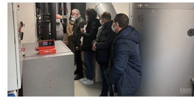
Dans la chaufferie de la Maison santé de Badonviller.
