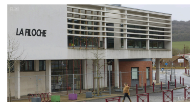
Des étais soutiennent une partie du bâtiment de La Filoche à Chaligny, suite à des fissures apparues sur celui-ci. Photo ER /Patrice SAUCOURT
