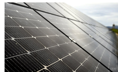
Lancement d'une étude sur les 19 communes de Moselle-et-Madon en vue d'équiper plusieurs toits de bâtiments publics de structures photovoltaïques. Photo ER /A. MARCHI
