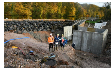
Devant la future passe à poissons, Claude Gourdon, le coordonnateur de chantier, Stéphane Thouvenin, responsable du bureau d'études et travaux neufs « grands ouvrages hydrauliques », et Édith Potasiak, chargée d'opération, tous deux de VNF.
