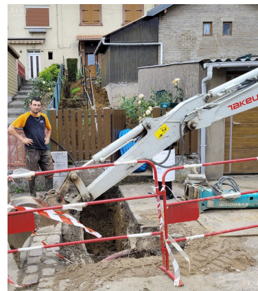
Il a fallu creuser la tranchée à la main dans le terrain de l'habitation.
