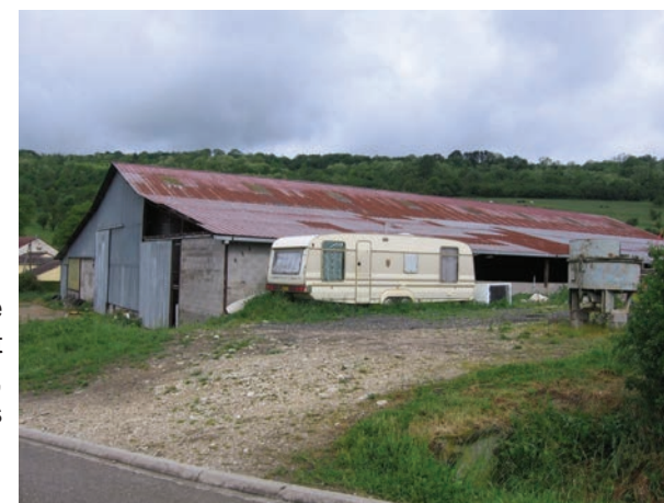
Des matériaux de construction inadaptés et des abords non traités, Maizières
